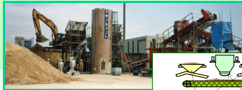
混合プラント
