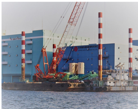
海上事前混合処理プラント
