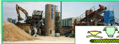
混合プラント
